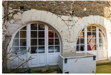
Détail des arcs sur le mur de pignon nord-est. Phot. Armelle Maugin IVR52_20254900275NUCA
