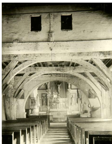
Nef de l'église de la Baroche-Gondouin avant reconstruction (?). Repro. Morgane Acou-Le Noan IVR52_20205300529NUCA
