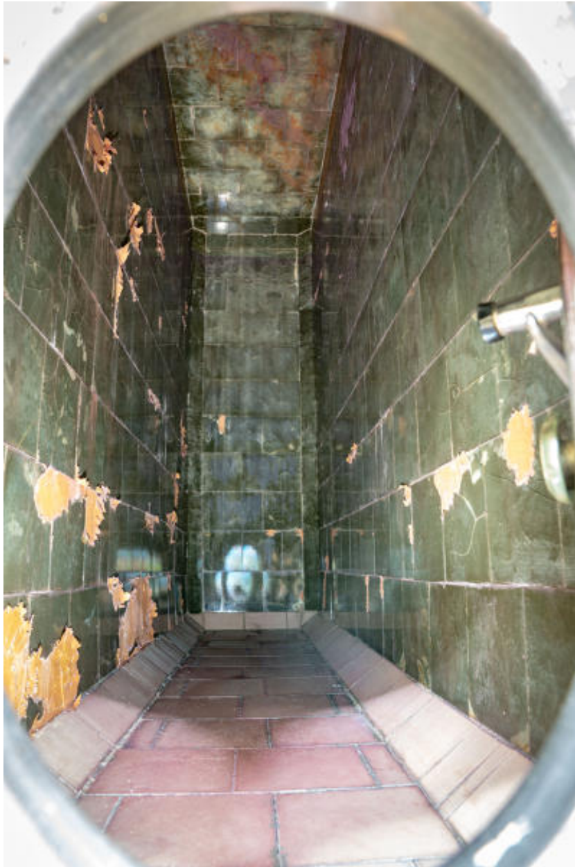
Une cuve verrée, aux carreaux en partie brisés (négoce Bahuaud, la Chapelle-Heulin).
