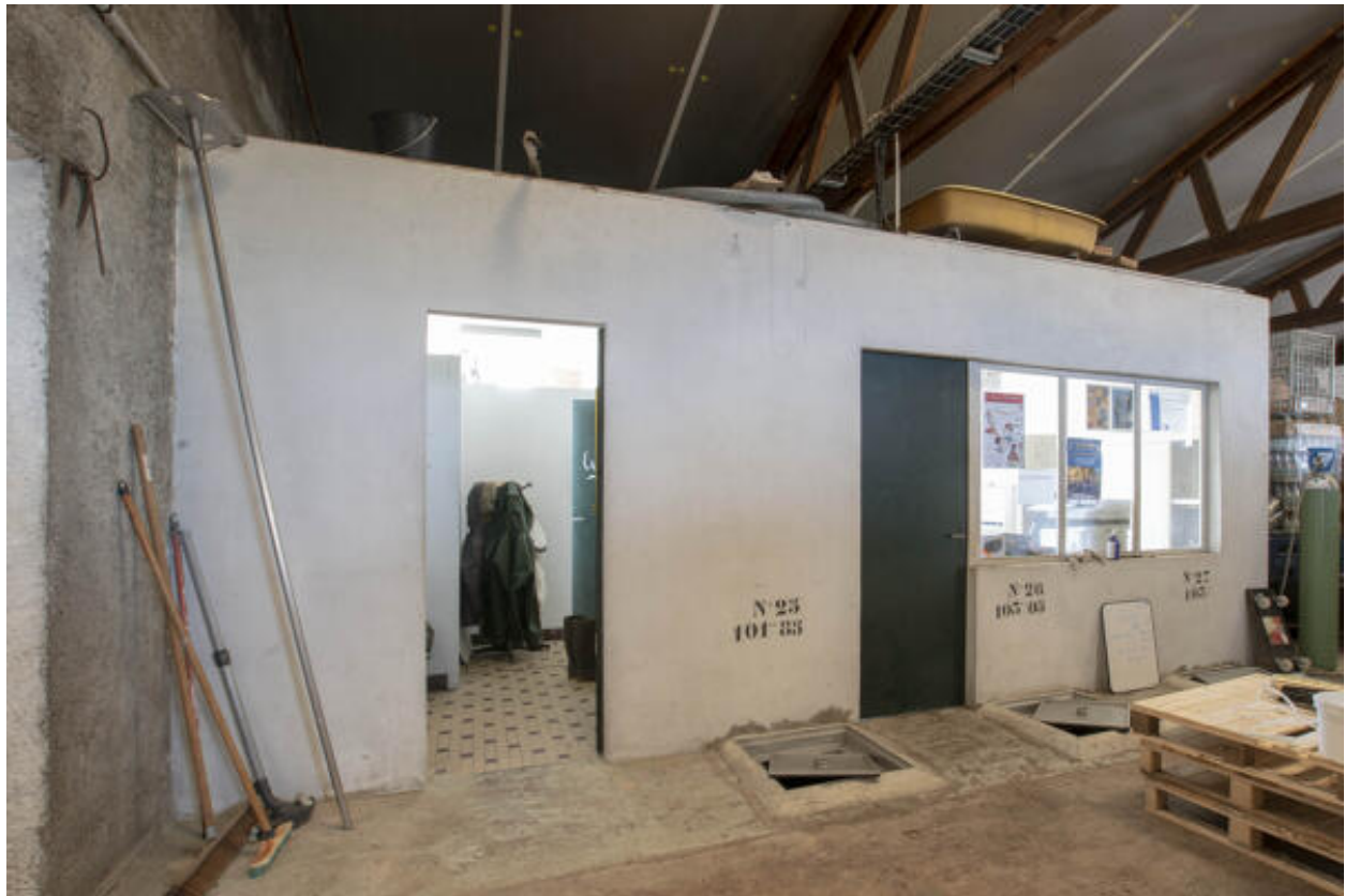
Trappes de cuves enterrées, à l'entrée des bureaux du négoce Giraud, la Haie-Fouassière.
