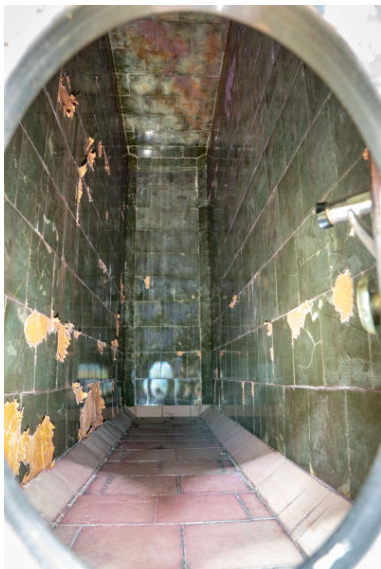
Une cuve verrée, aux carreaux en partie brisés (négoce Bahaud, la Chapelle-Heulin). Phot. Pierre-Bernard Fourny IVR52_20214401020NUCA
