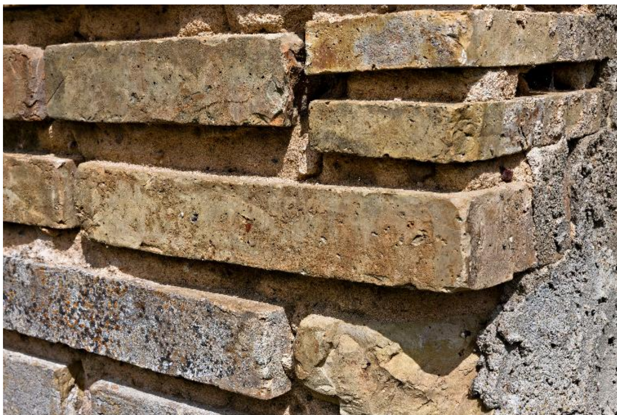
Détail du même appareillage.
