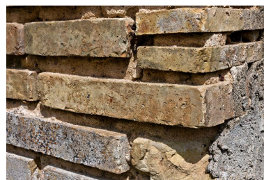
Détail du même appareillage. Phot. Yves Guillotin IVR52_20147201785NUCA
