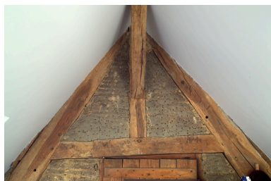
Cloison en terre dans le comble du corps nord. Phot. Denis Pillet IVR52_20074400655NUCA
