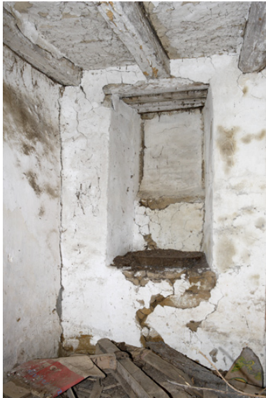
Aile sud. Fenêtre bouchée. Phot. Denis Pillet IVR52_20084402178NUCA
