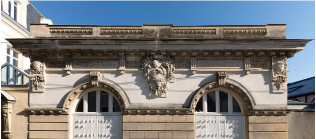
Détail du décor sous corniche de la façade principale de l'atelier rue du Clos-Margot.
