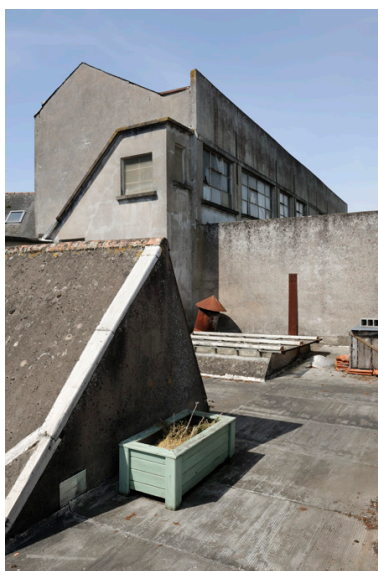
Vue du bâtiment construit en 1948, depuis le toit terrasse de la première usine. Phot. Bruno Rousseau, Phot. Youenn Communeau IVR52_20114901130NUCA
