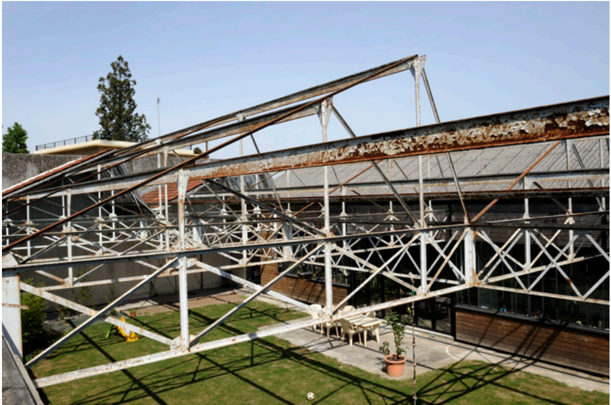
Détail des charpentes métalliques (sheds et toit à longs pans) des vaisseaux construits en 1933-1934.
