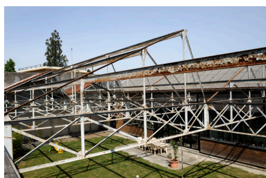
Détail des charpentes métalliques (sheds et toit à longs pans) des vaisseaux construits en 1933-1934. Phot. Bruno Rousseau, Phot. Youenn Communeau IVR52_20114901128NUCA
