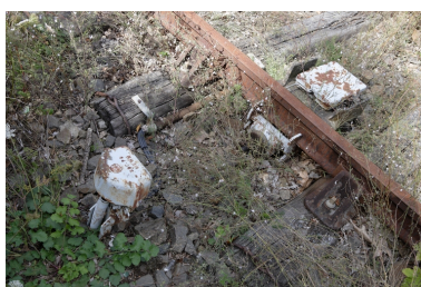
Pédales de réarmement et boîtier de jonction, PN 312, côté Châteaubriant. Phot. Denis Pillet IVR52_20104402082NUCA
