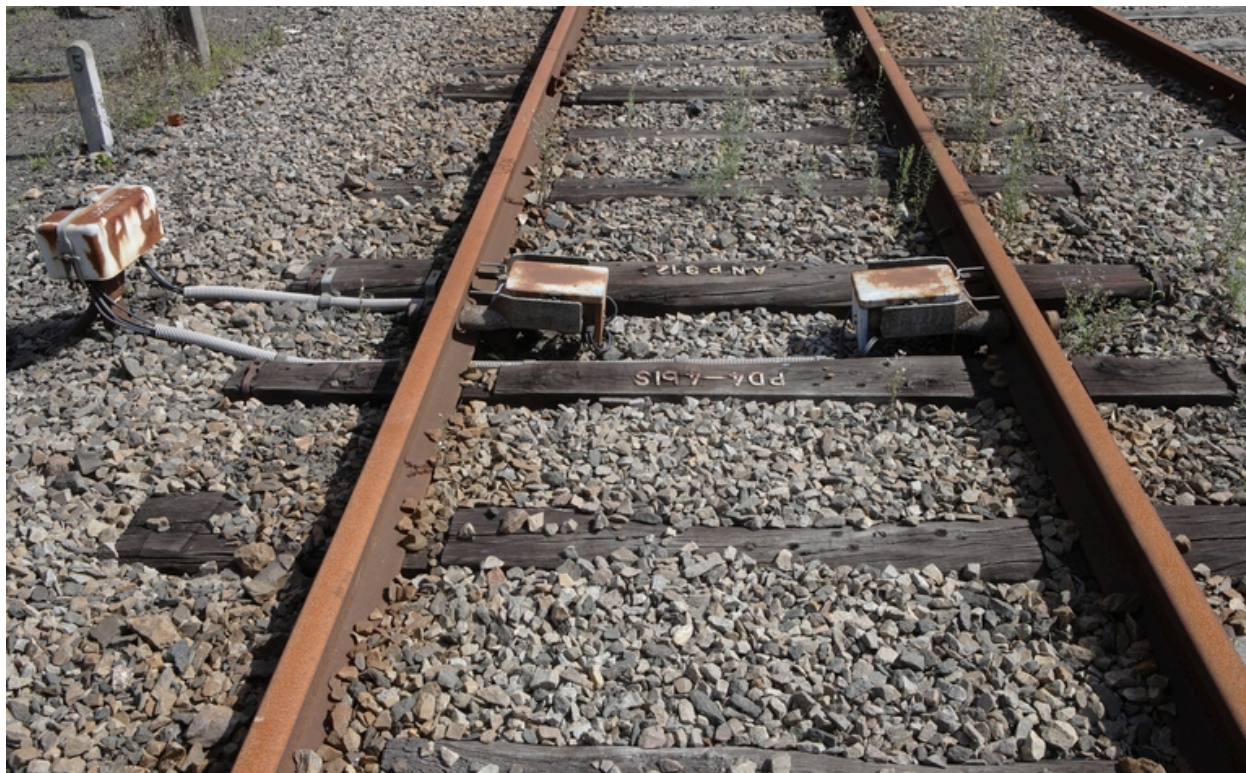
Pédales de réarmement, électromécaniques, PN 312, côté Nantes.
