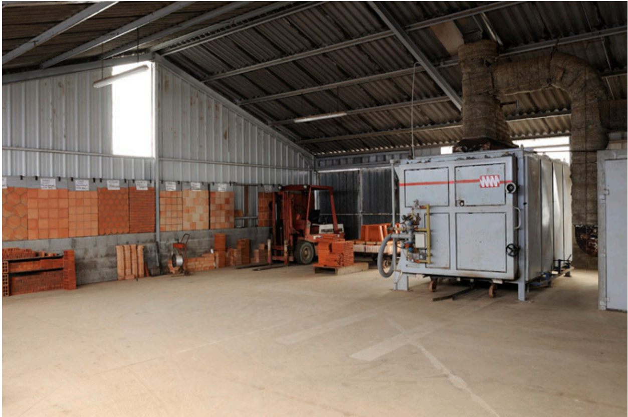
Pièce de stockage et four à gaz.
