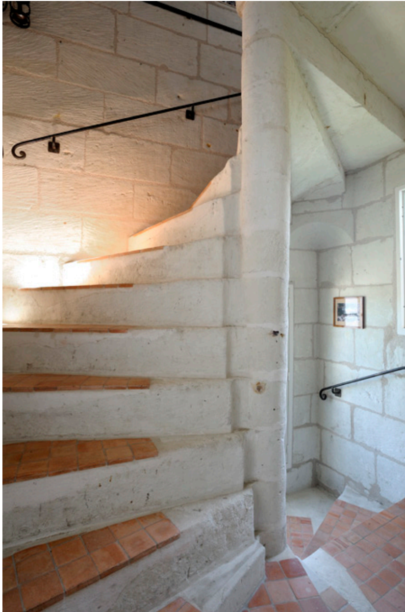
Tourelle d'escalier hors-oeuvre. Escalier en vis (remanié), avec marches à gorge au collet et marche d'angle reposant sur une trompe.
