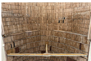
le lambris de couverture de la nef. En bas, les vestiges du lambris installé en 1563. En haut, le lambris refait entre 1862 et 1866. Phot. Yves Guillotin IVR52_20127201255NUCA
