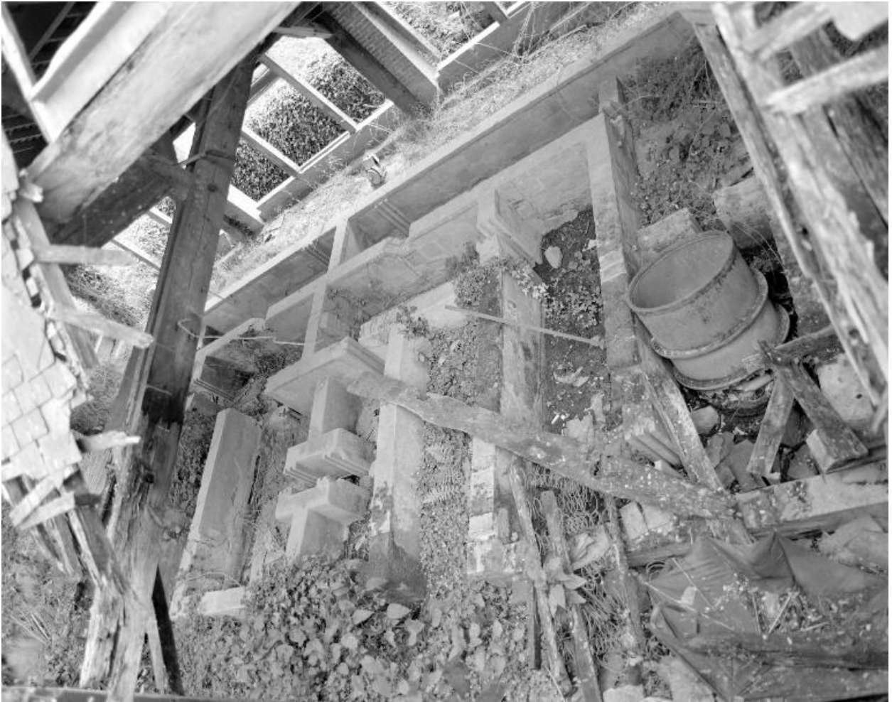
Le bâtiment situé au nord-ouest. Vue intérieure depuis le chemin de halage, à travers la toiture effondrée.
