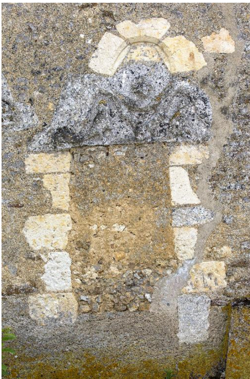
Nef, mur nord, détail : baie murée, éléments de décor mal repositionnés.
