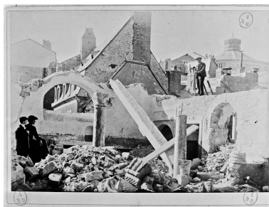
Démolition Eglise Saint-Julien, bas des murs et deux colonnes debout, photogr., fin 19e siècle. Repro. Patrice Giraud, Repro. François Lasa IVR52_19794900604X
