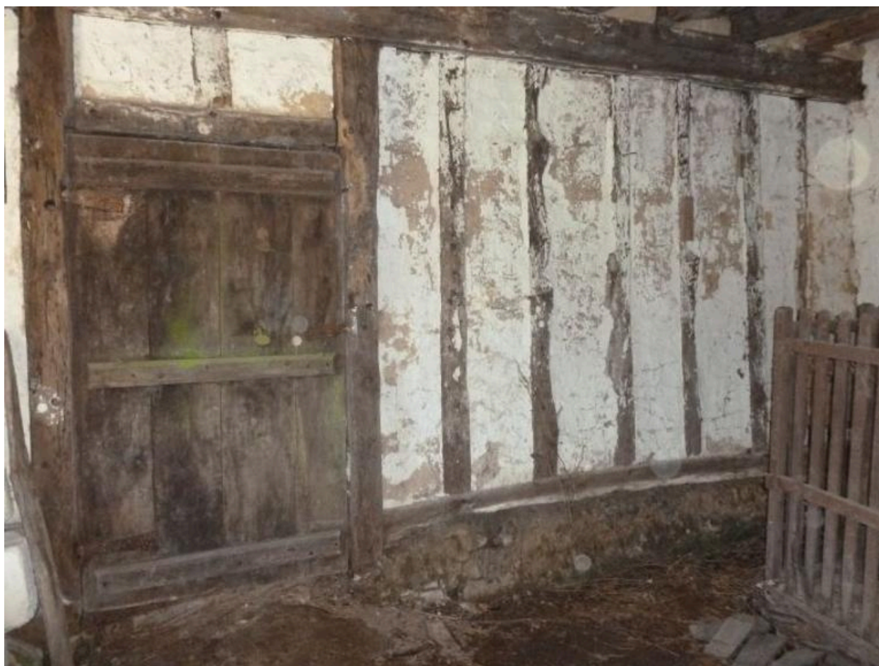
Détail de la chambre froide.
