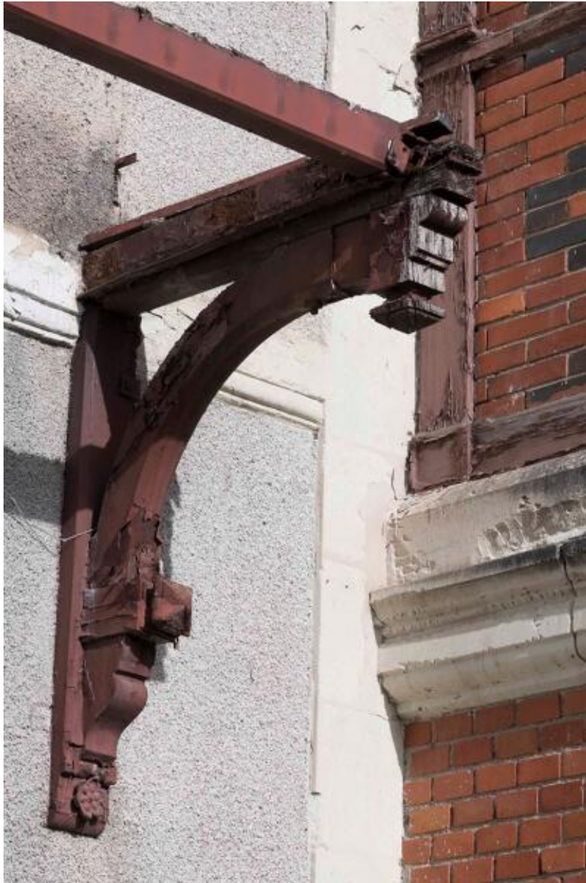
Façade est. Vestige de l'ancien balcon en bois.
