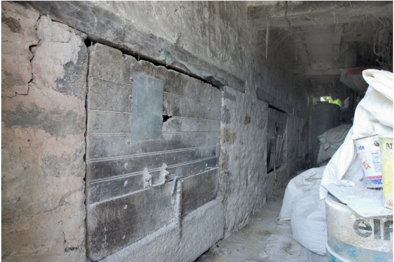
La porcherie : trappes servant à l'alimentation des porcs.
