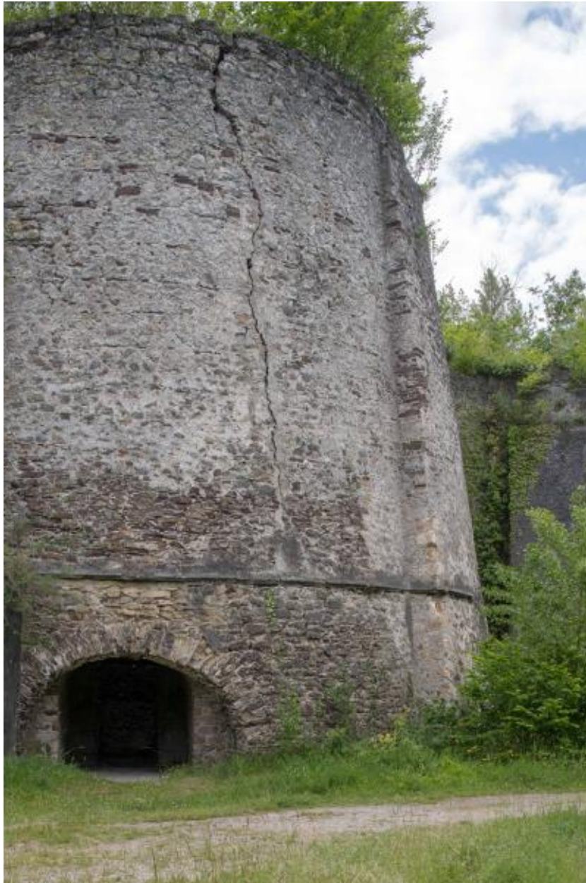
Four à chaux de l'Union, vue depuis le nord, au-dessus de l'ébraisoir solin, vestiges de la chambre de compression (système Bied), Maison-Blanche, Montjean-sur-Loire.
