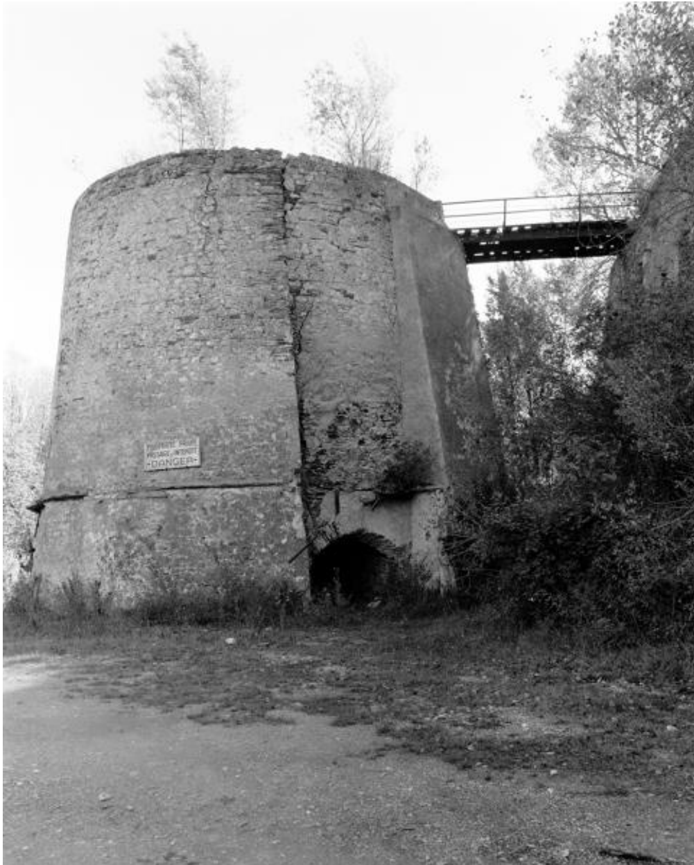
Four à chaux de l'Union, au dessus de l'ébraisoir solin et arrachements métalliques, vestiges de la chambre de compression (système Bied), Maison-Blanche, Montjean-sur-Loire.
