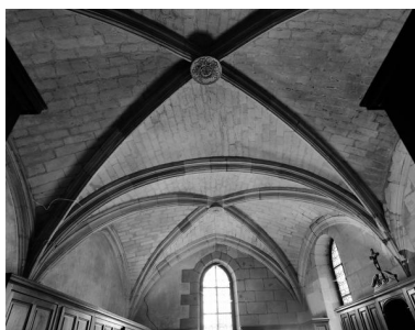
Sacristie : vue d'ensemble des voûtes, de l'entrée au sud vers le nord. Phot. François Lasa IVR52_19974900404V
