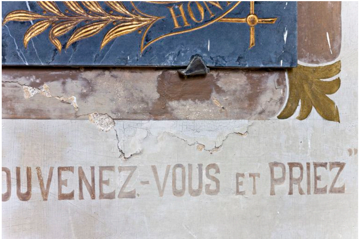
Nef, mur nord. Monument aux morts : détail de la zone en mauvais état de conservation
