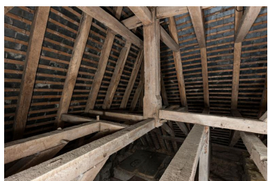
Charpente du pavillon dit "Pavillon de l'Horloge" - détail Phot. Yves Guillotin IVR52_20195300002NUCA
