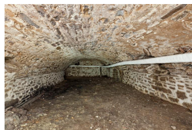
Cave du corps principal du couvent des bénédictines de Lassay, vue vers l'ouest, ouvertures de soupirax sur le mur nord Phot. Yves Guillotin IVR52_20195300008NUCA
