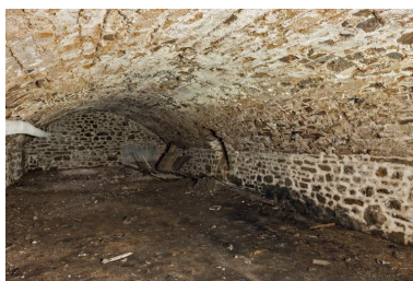
Cave voûtée du corps principal du couvent des bénédictines de Lassay, vue vers l'est Phot. Yves Guillotin IVR52_20195300007NUCA
