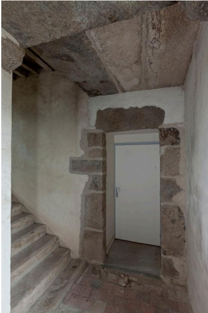
Palier du premier niveau de l'escalier ouest du couvent, porte vers le corps de bâtiment nord
