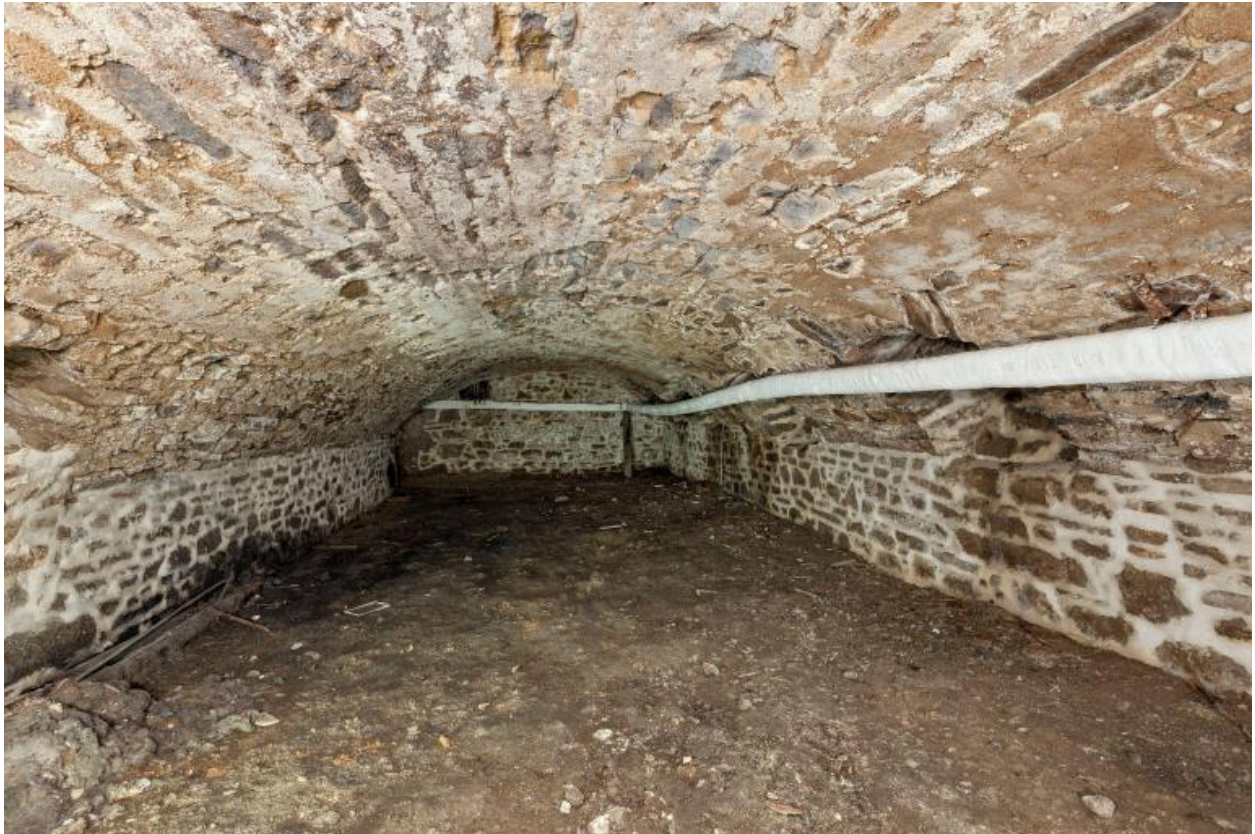
Cave du corps principal du couvent des bénédictines de Lassay, vue vers l'ouest, ouvertures de soupiraux sur le mur nord
