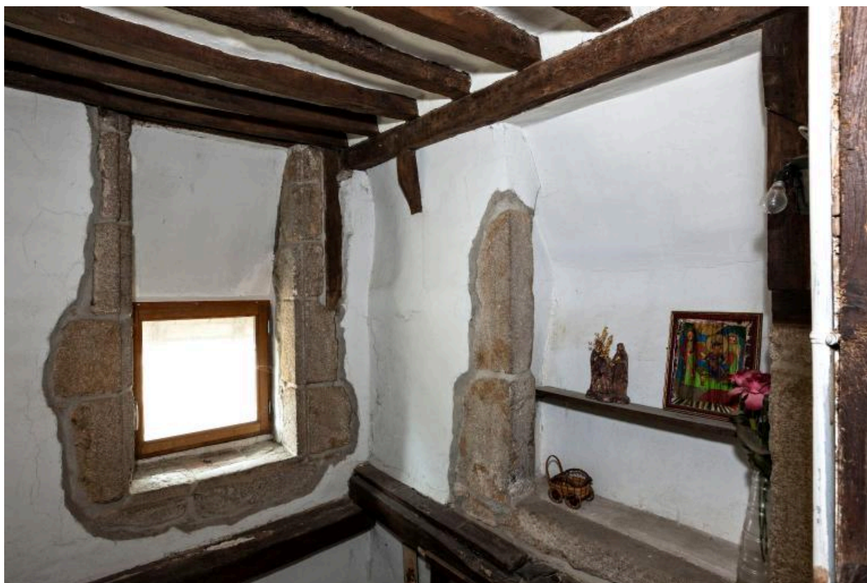
Maison, dite "Pavillon de l'Horloge", vue de deux ouvertures au premier étage de la cage d'escalier
