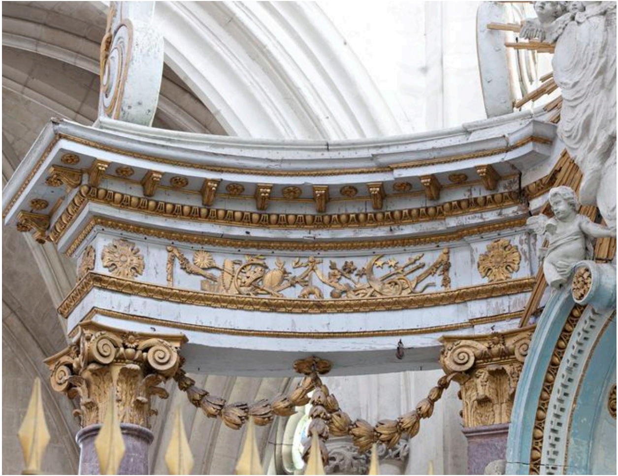
Partie gauche de l'entablement. Noter, à droite, la rupture entre la partie en bois et la partie en pierre.
