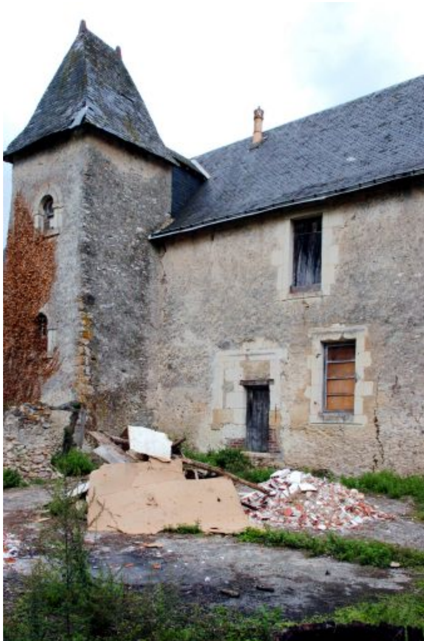
Façade sur cour, détail : croisée en partie bouchée.
