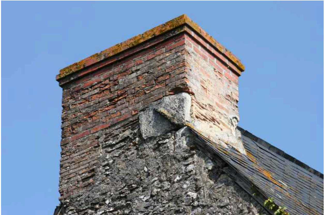
Pignon sud, détail : vestige d'un rondelis en tuffeau.
