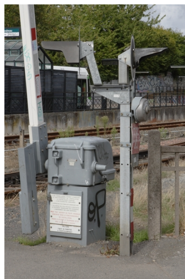
Signal lumineux d'avertissement, PN 310. Phot. Denis Pillet IVR52_20104402062NUCA
