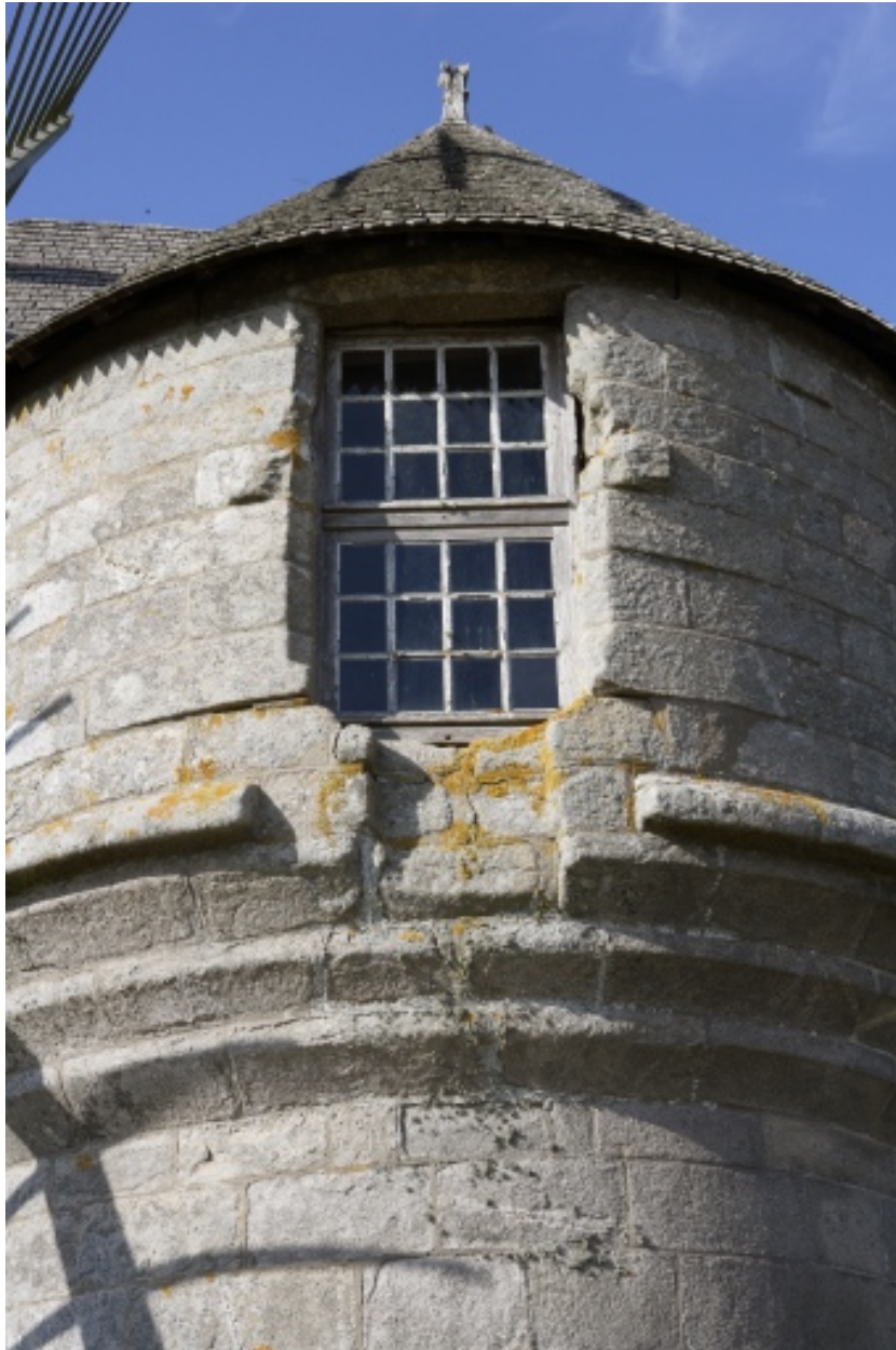
Moulin de Crémeur. Porte haute sud-est avec les vestiges des corbeaux du travouillet.
