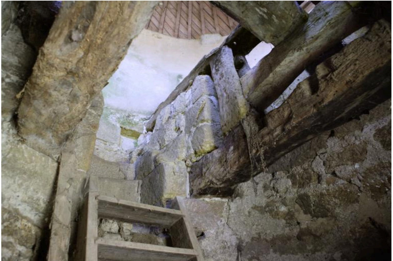
Moulin de Drézeux. Intérieur de la tourelle. Le petit escalier en angle menant à l'étage. De part et d'autre, les deux cadres en bois de la trempure.
