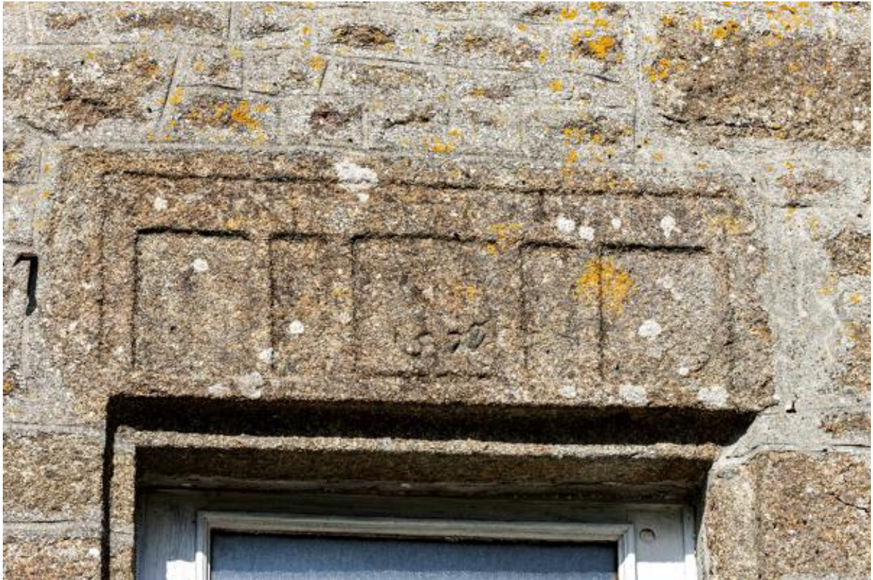
Hameau de l'Aubergement, linteau de porte du logis principale, portant la date 1579.
