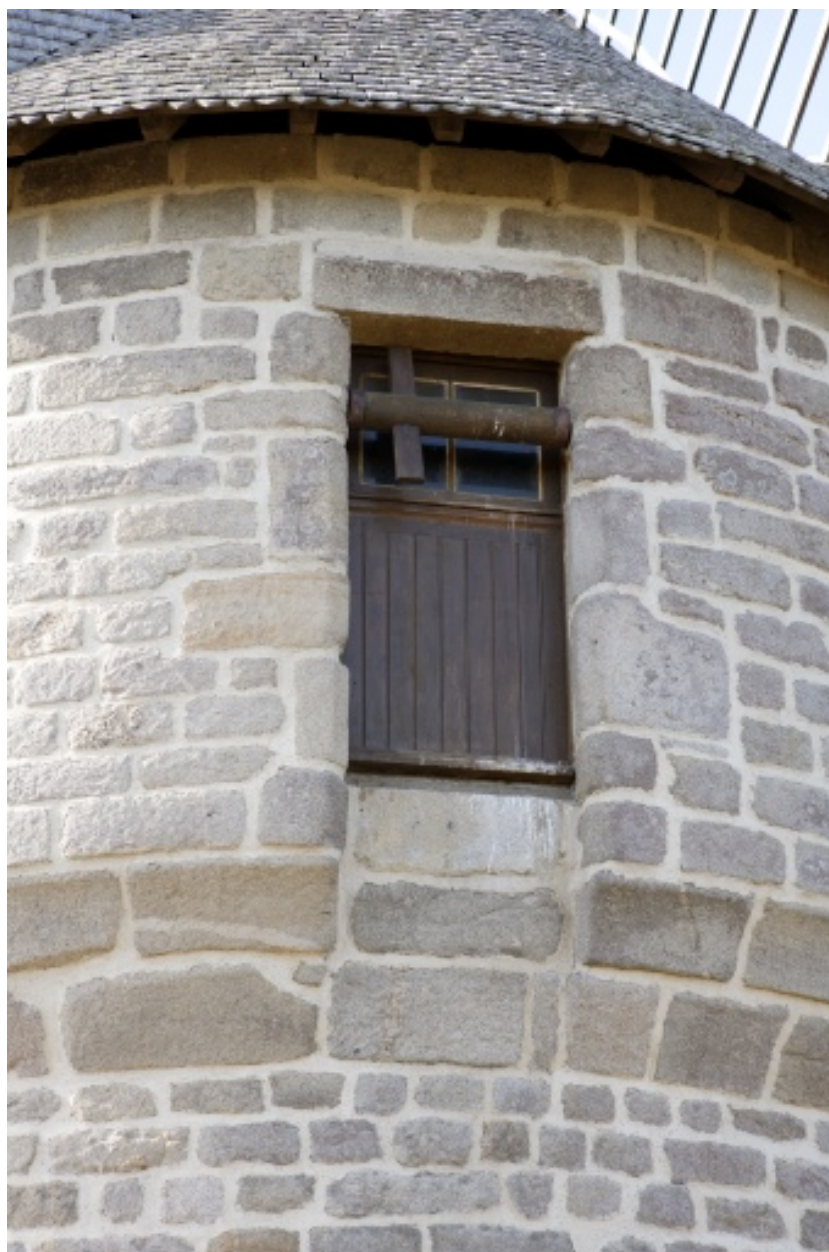
Cage, côté est. Détail de l'une des deux portes haute et du treuil.
