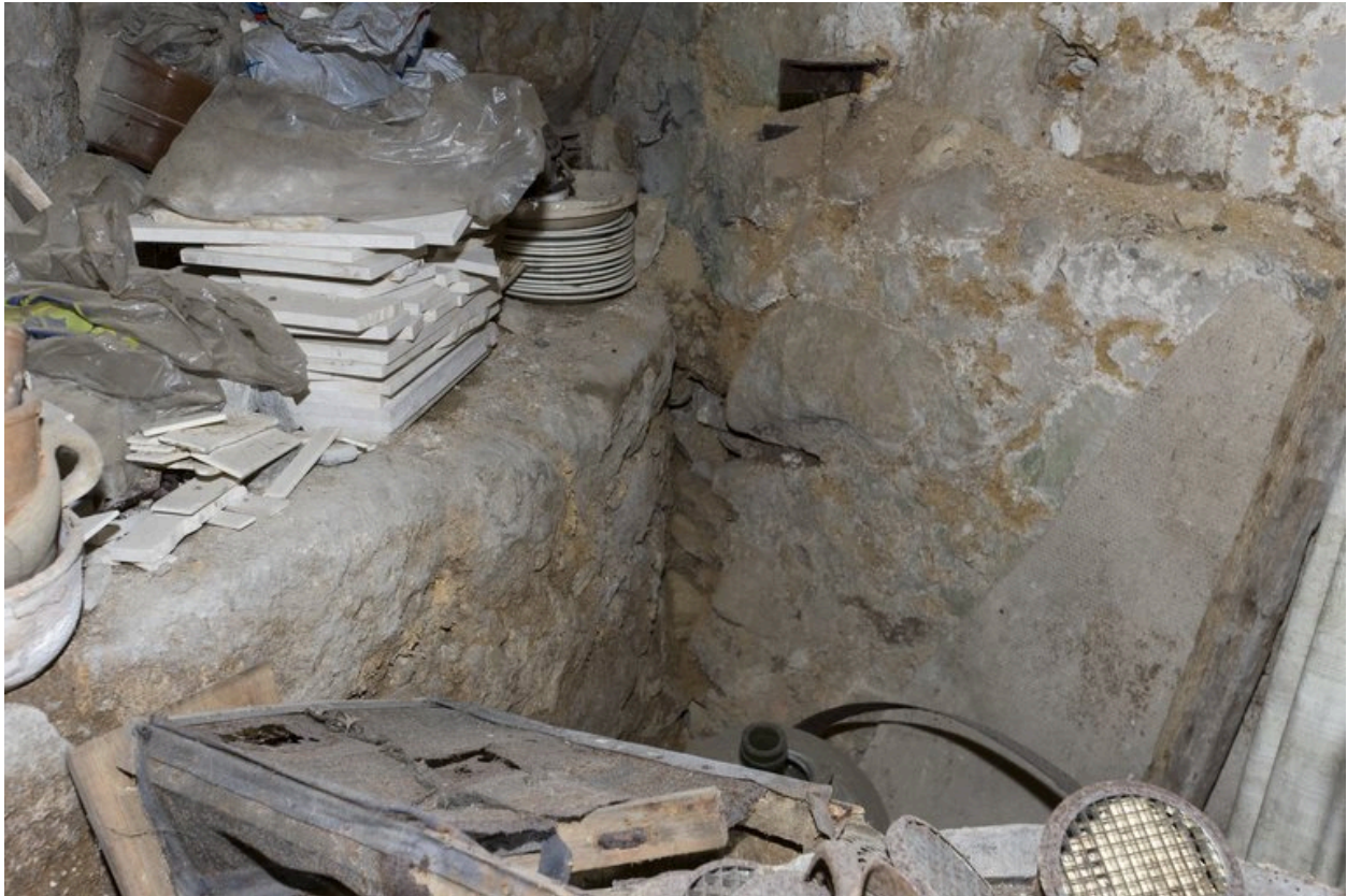
Vue prise du sous-sol de la maison 7, rue des Chanoines, montrant le parement extérieur de la glacière.
