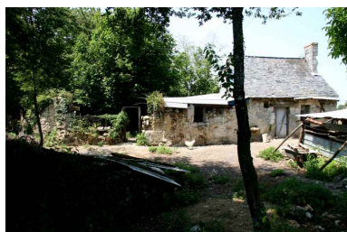
maison 1 ruinée. Phot. Jean-Baptiste Darrasse IVR52_20067206071NUCA
