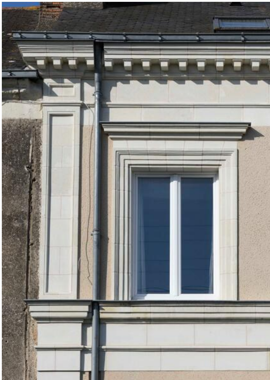
Maison 3 rue d'Anjou : détail d'un pilastre d'angle, d'une baie et de la corniche à modillons.
