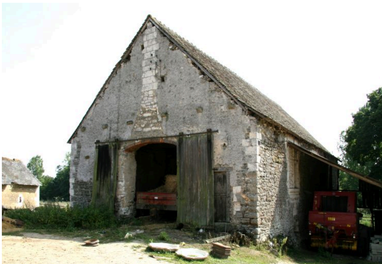
Pignon nord éventré à l'empacement de la grande cheminée du rez-de-chaussée.
