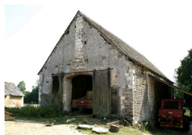
Pignon nord éventré à l'emplacement de la grande cheminée du rez-de-chaussée. Phot. Jean-Baptiste Darrasse IVR52_20077201482NUCA
