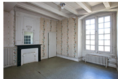
Le logis, 1er étage, chambre 1 : cheminée et lambris. Phot. Yves Guillotin IVR52_20117200752NUCA
