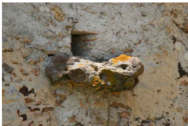
Façade postérieure : écoulement de l'évier. Phot. Jean-Baptiste Darrasse IVR52_20067205660NUCA
