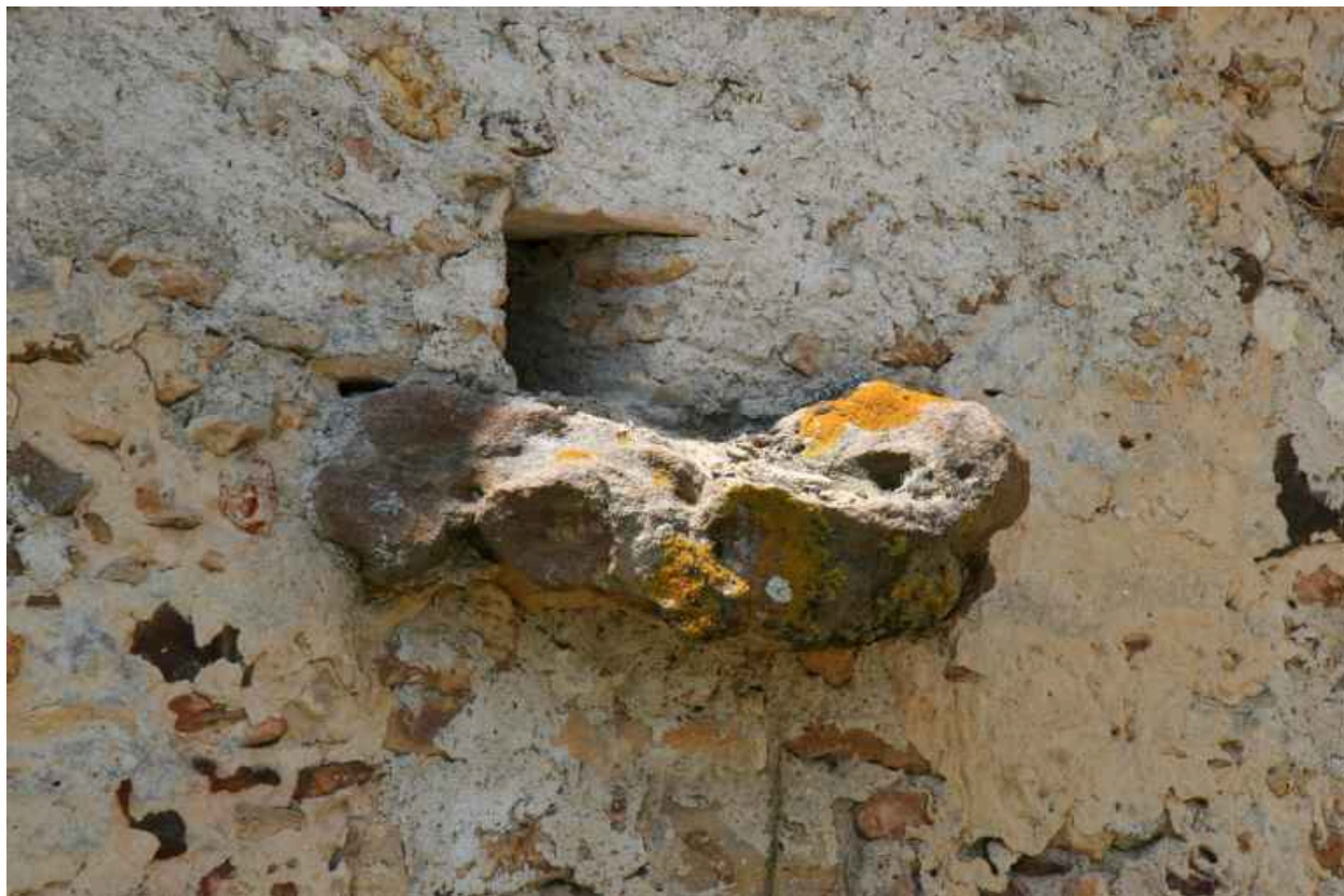
Façade postérieure : écoulement de l'évier.
