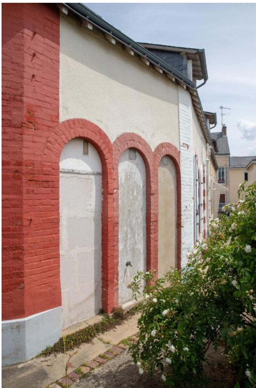
Vue des salles d'eau communes aujourd'hui condamnées.
