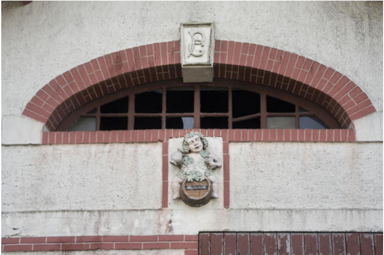
Baie en surplomb de la façade principal du bâtiment primitif, site de la rue des Rosiers.
