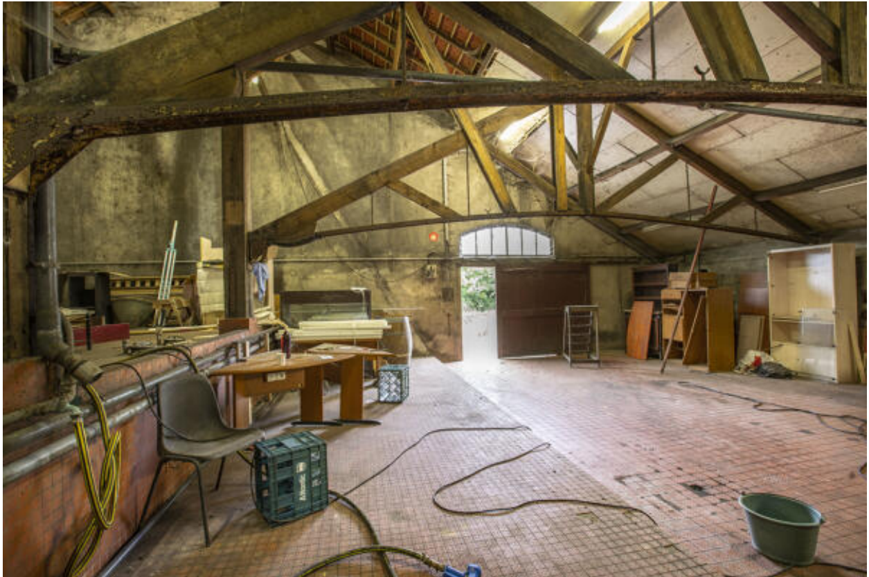
Cuverie principale et quai, niveau supérieur.
