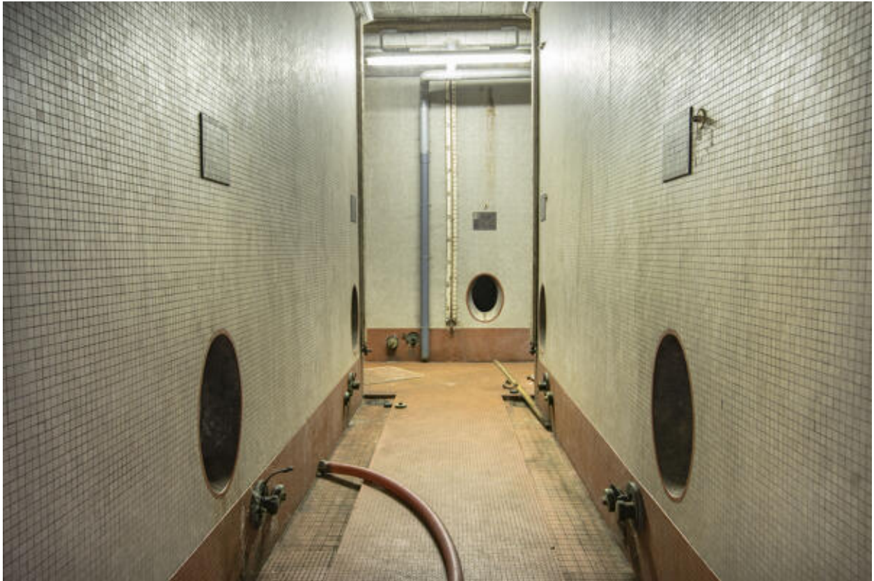
Cuverie principale, niveau inférieur.
