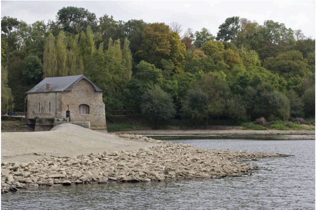
Les façades nord et ouest vues depuis la rive droite, pendant les écourues de 2009.
