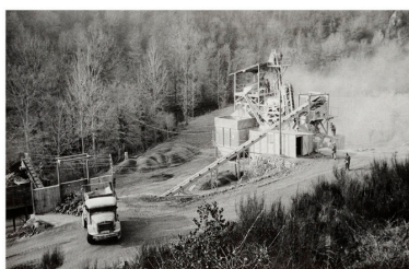
Exploitation d'une carrière par la Société Chupin- Vigneron, dans les années 1950. Repro. Bruno Rousseau IVR52_20114900564NUCA
