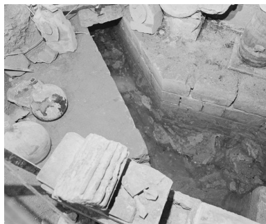
Sous-sol, système hydraulique, détail des canalisations. Phot. Bruno Rousseau IVR52_19964901449X
