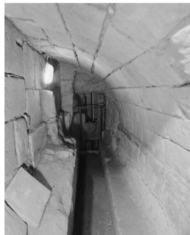
Sous-sol, système hydraulique, détail des canalisations. Phot. Bruno Rousseau IVR52_19964901442X
