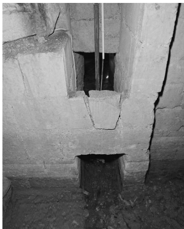
Sous-sol, système hydraulique, détail des canalisations. Phot. Bruno Rousseau IVR52_19964901439X
