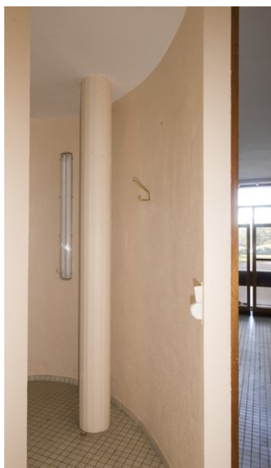
Accès à l'armoire électrique, au rez-de-chaussée. Phot. Patrice Giraud IVR52_20108500100NUCA
