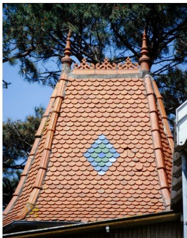
Détail du toit polygonal, couvert de tuiles en écailles, de la tour d'angle. Phot. Denis Pillet IVR52_19954400278XA
