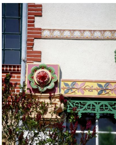
Détail d'un cabochon et de carreaux en terre cuite vernissée. Phot. Denis Pillet IVR52_19954400279X
