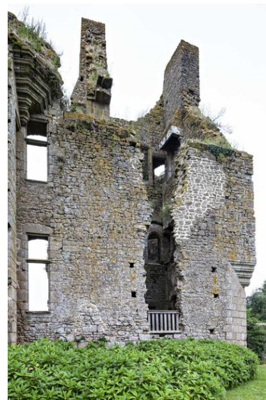
Mur sud de l'aile nord du corps de logis nord-ouest. Phot. Yves Guillotin IVR52_20215301369NUCA
