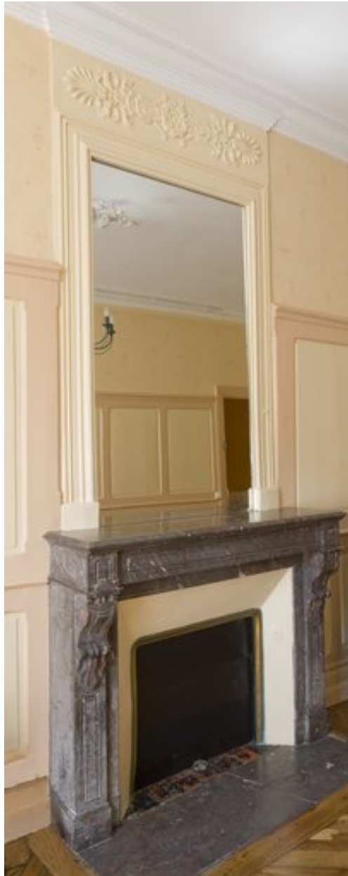
Cheminée de la première moitié du XIXe siècle, au rez-de-chaussée de la maison.
