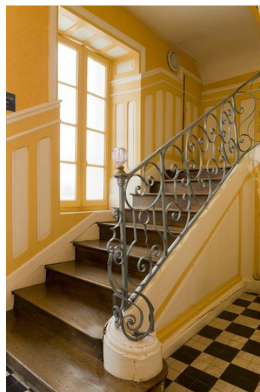
Départ de l'escalier en pierre, à rampe en fer forgé. Les marches, en pierre, ont été recouvertes en bois, du fait de l'usure de la pierre. Phot. Patrice Giraud IVR52_20098500243NUCA
