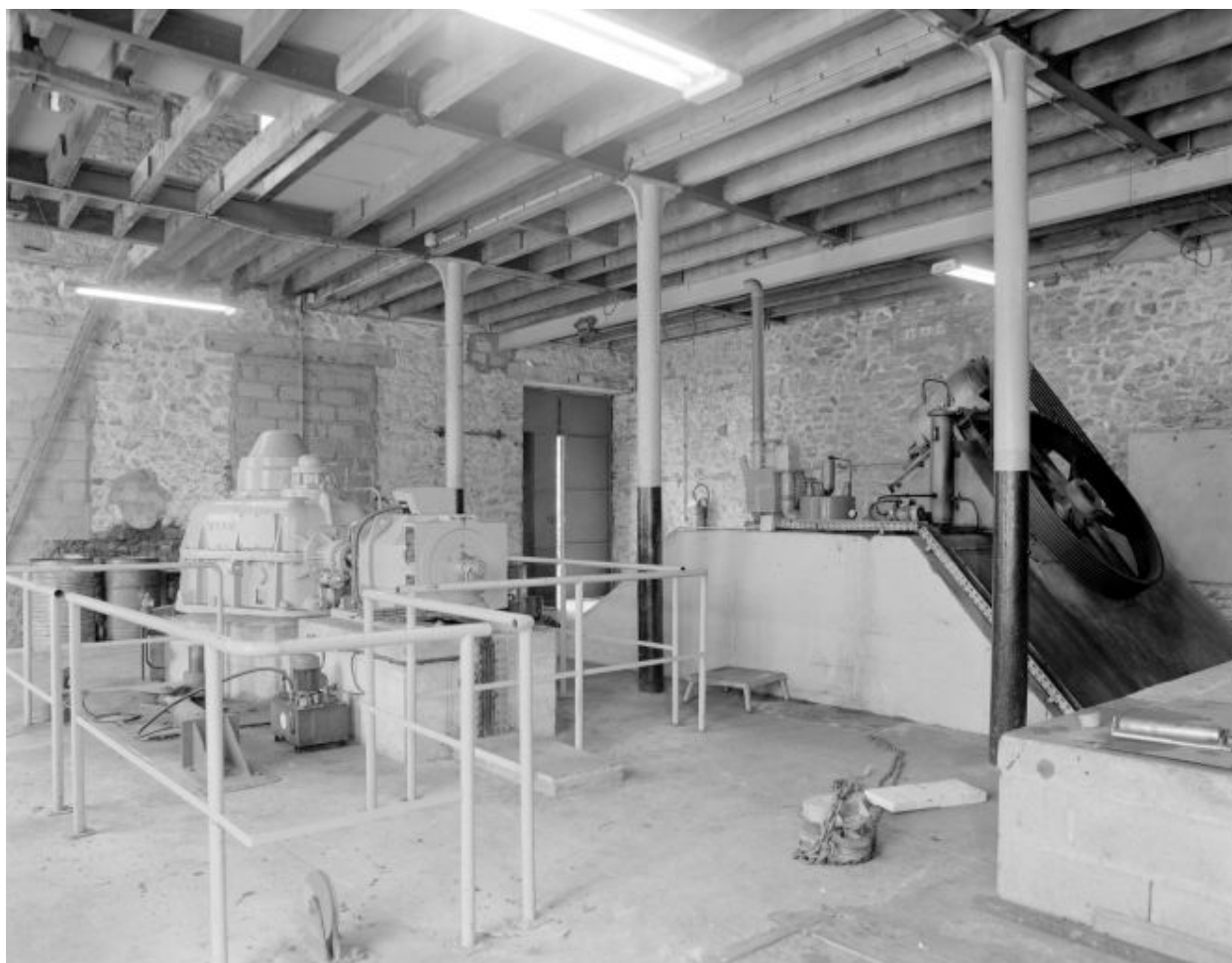
Vue d'ensemble du rez-de-chaussée depuis le nord-est : à gauche, le multiplicateur et le générateur est ; à droite, ceux de l'ouest.
