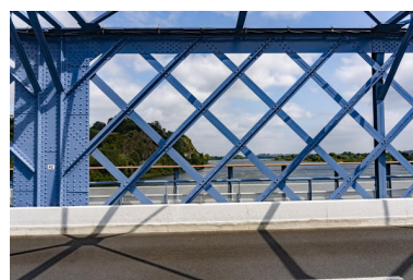
Vue de détail du treillis de la charpente métallique. Phot. Pierre-Bernard Fourny IVR52_20214400903NUCA
