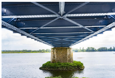
Vue de détail de la charpente métallique soutenant le tablier. Phot. Pierre-Bernard Fourny IVR52_20214400905NUCA
