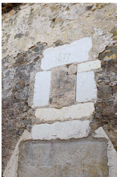
Bourg. 10 rue des Mauges. Détail d'un jour daté 1633. Phot. Armelle Maugin IVR52_20254900406NUCA
