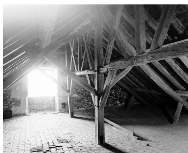
Bâtiment du noviciat, second étage de comble : vue d'ensemble de la charpente d'est en ouest.
