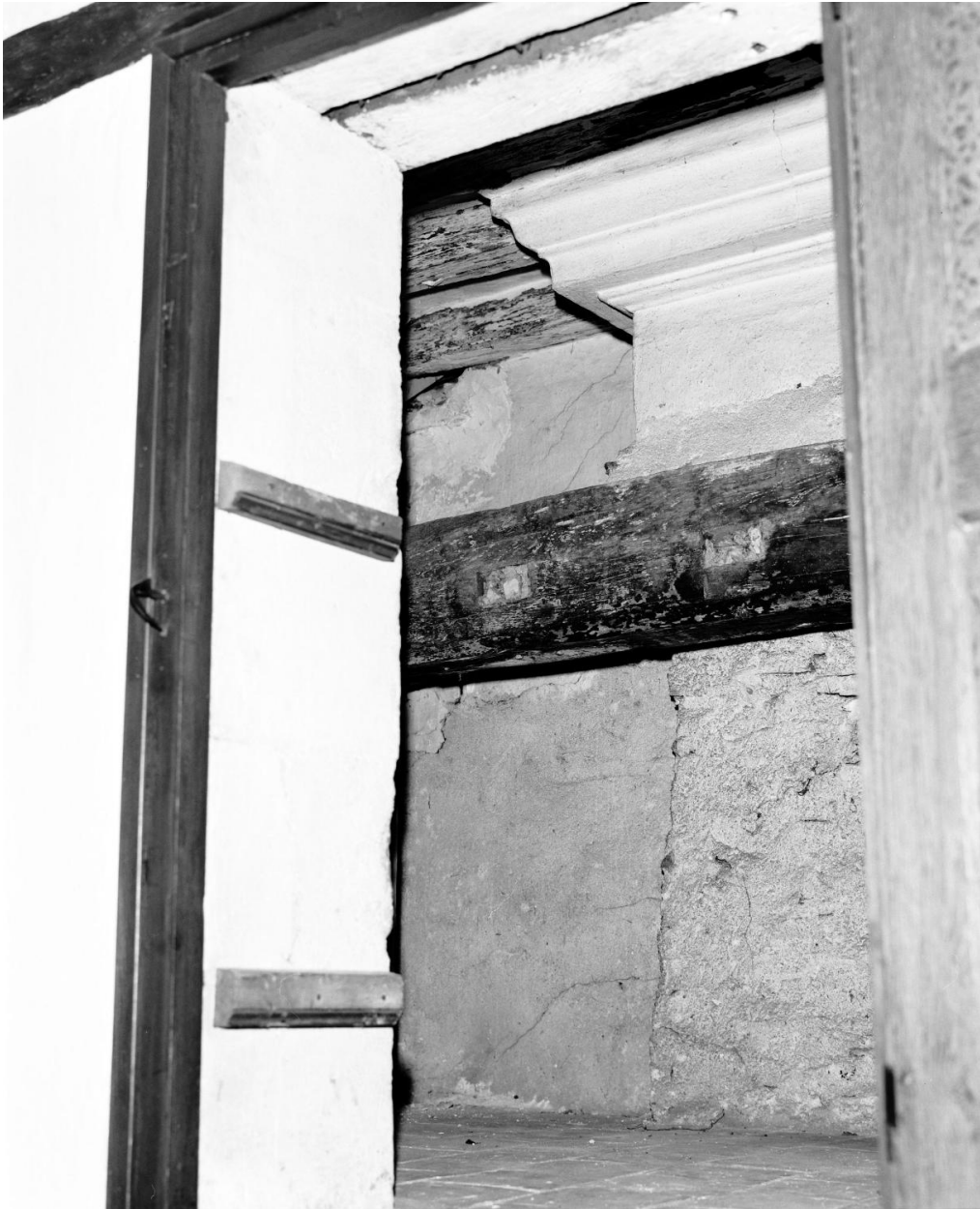
Bâtiment du noviciat, rez-de-chaussée (occupé par une boulangerie en 1808), mur est : vestiges d'une hotte de cheminée.
