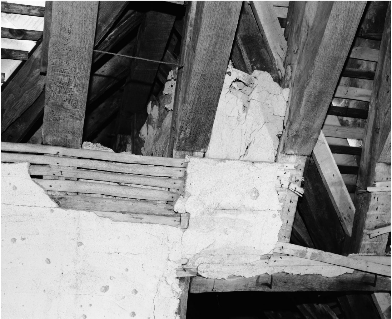
Corps de bâtiment de l'avant-choeur et du chœur des religieuses, étage de comble, partie est : traces d'un lambris de couverture.
