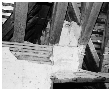
Corps de bâtiment de l'avant-choeur et du chœur des religieuses, étage de comble, partie est : traces d'un lambris de couverture. Phot. François Lasa IVR52_19974900937X
