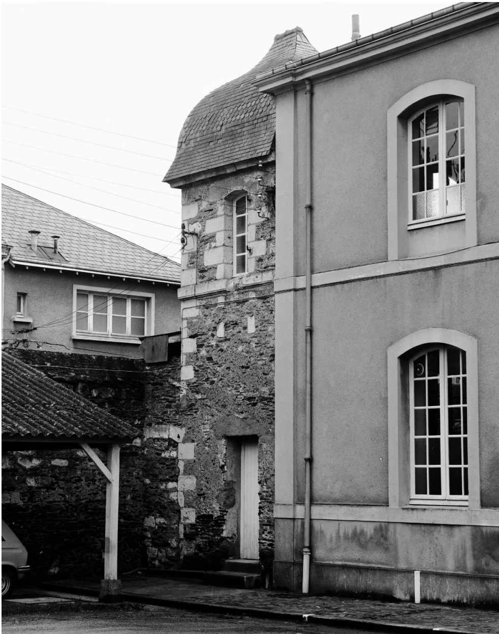
Ancienne cour d'entrée de la marquise de Férolle (41 rue Lionnaise), pavillon jouxtant à l'est l'aile double des parloirs et logis de la marquise : élévation sur cour.
