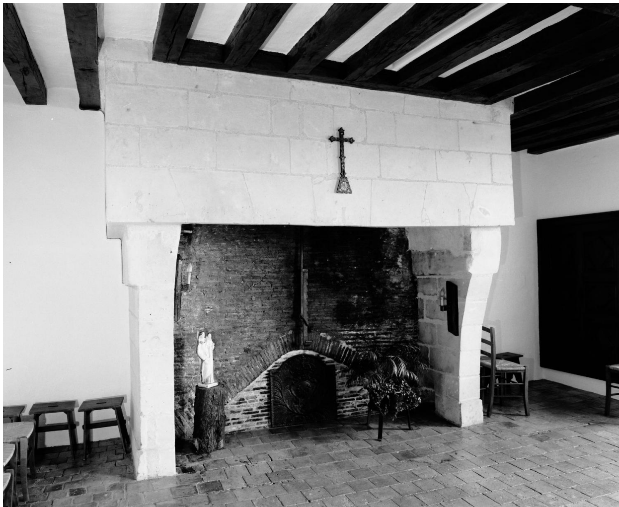
Aile sud du cloître, premier étage, actuelle salle de communauté, mur est : la cheminée.
