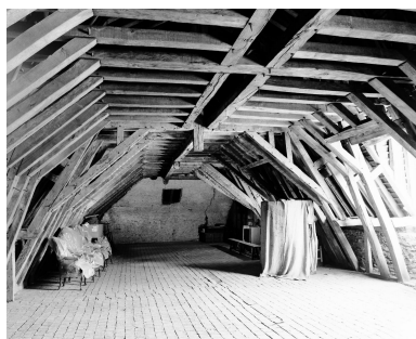
Aile nord du cloître, étage de comble, partie est de la charpente, vue depuis l'ouest. Au premier plan, partie avec premier sous-faîtage dédoublé marquant la seconde campagne de construction.
