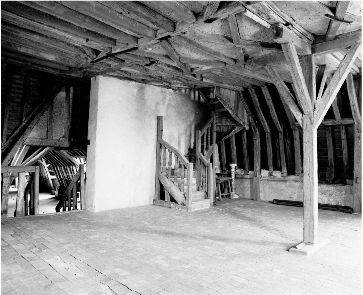
Bâtiment du noviciat, premier étage de comble : vue d'ensemble d'ouest en est. Au fond, comble de l'aîle nord.
