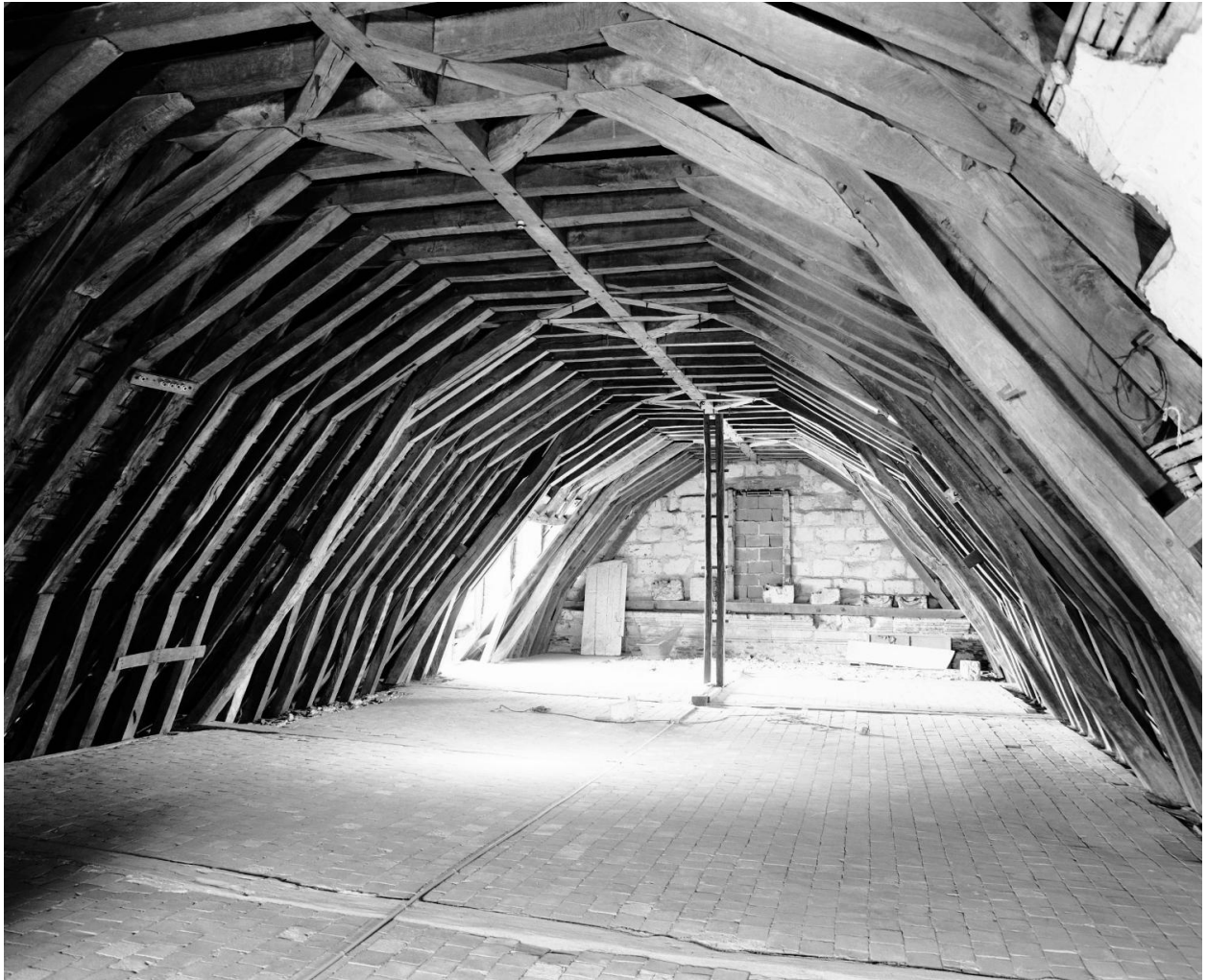
Corps de bâtiment de l'avant-choeur et du choeur des religieuses, étage de comble : vue d'ensemble de la charpente d'ouest en est. Sur le mur du fond, en partie basse, vestige de la corniche de l'église primitive.
