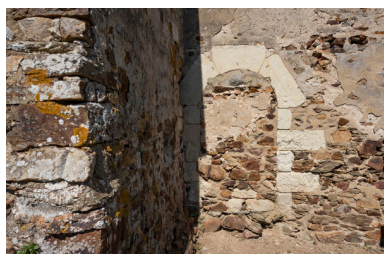
La porte murée de la façade latérale sud du logis. Phot. Thierry Seldubuisson IVR52_20225300752NUCA
