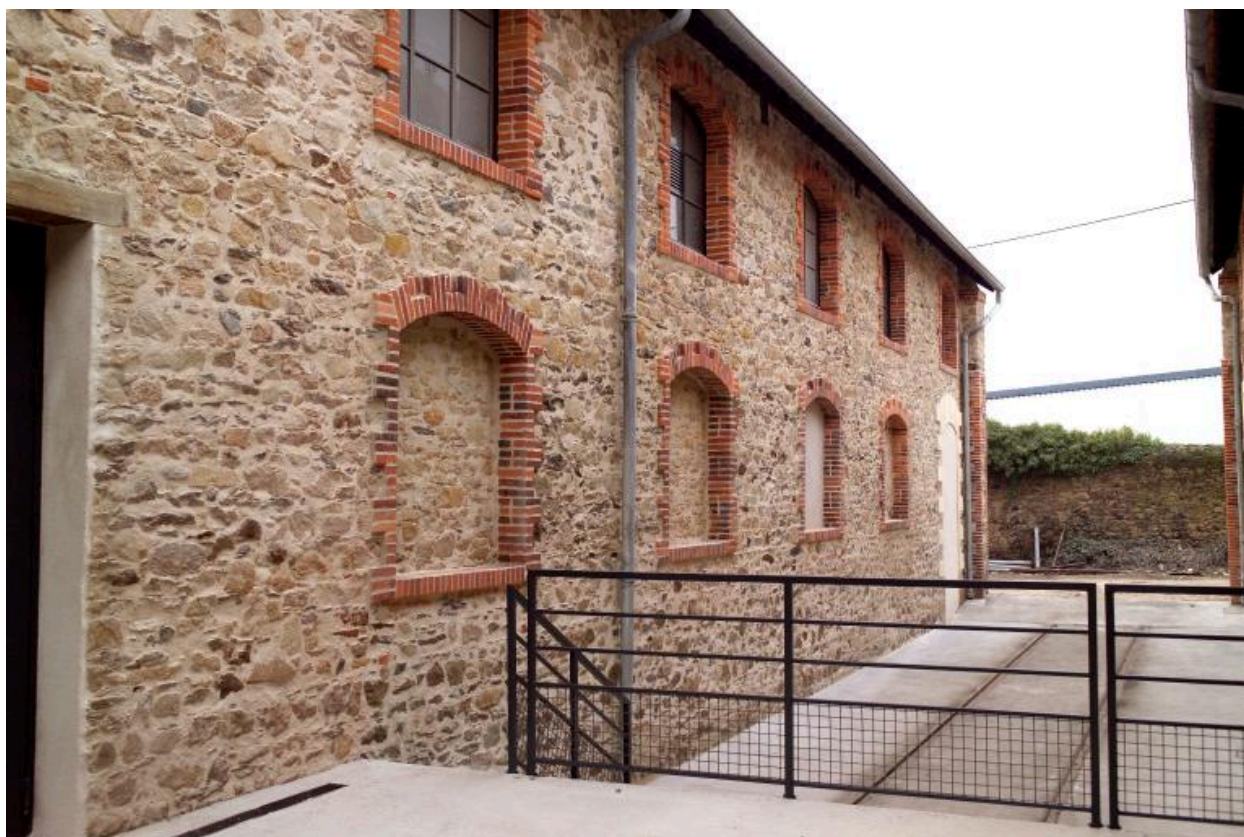
Façade est du bâtiment central (B, G du plan) vue du sud de l'allée entre les bâtiments ouest et central.
