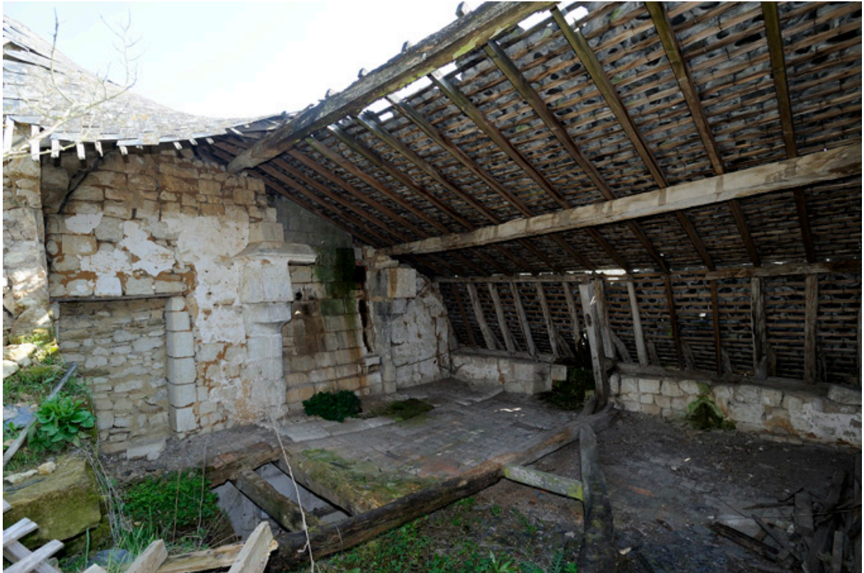
Façade postérieure (ruinée) : vue de l'intérieur de l'actuel comble.
