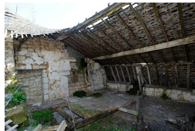
Façade postérieure (ruinée) : vue de l'intérieur de l'actuel comble. Phot. Bruno Rousseau, Phot. Youenn Communeau IVR52_20114900652NUCA
