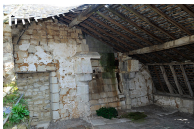
Vue du comble actuel (ancienne salle haute sous charpente, remaniée), avec cheminée du XVe ou du début du XVIe siècle. Phot. Bruno Rousseau, Phot. Youenn Communeau IVR52_20114900653NUCA
